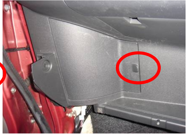
ヒューズBOXのカバーを開けます
